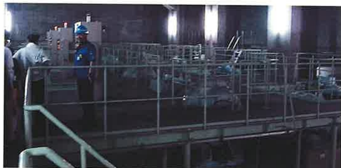
内部ポンプ室
